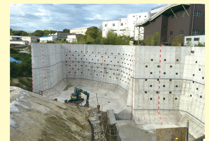
■高さ最大10mのL型擁壁築造による造成工事(平成28年9月)
