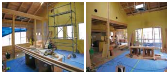
▲着々と施工されている現場の状況。杉の現し天井、壁は白い「しっくのみ」で施工予定。
